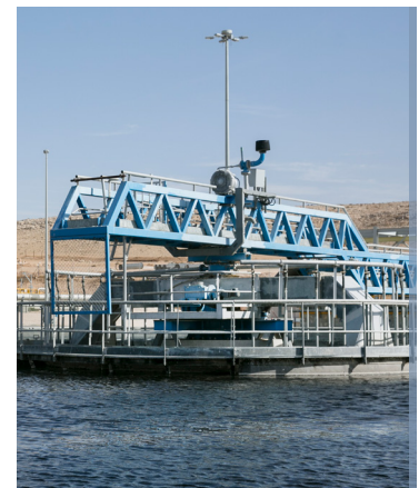
Traitement des eaux usées, As Samra, Jordanie
