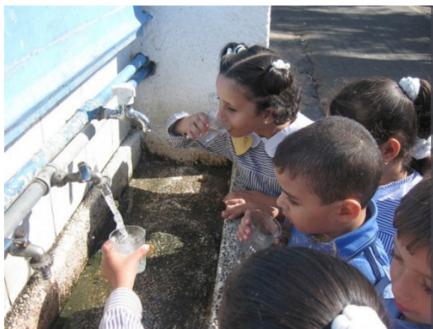
Station de remplissage d'eau, Gaza
